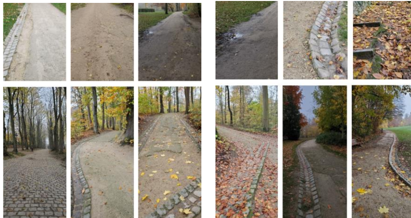
État existant des chemins en dolomie et problèmes de nivellement par rapport aux caniveaux (photos jointes à la demande)
