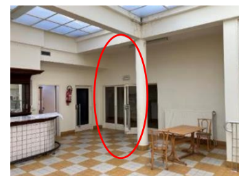
Cafeteria avec indication de l'implantation du nouvel ascenseur - extr. du dossier de demande
