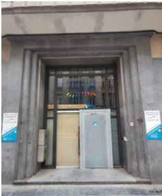
Bestaande / oorspronkelijke deur Koningsstraat met ongepaste ingreep ter hoogte van de deurvleugels – © StreetView
